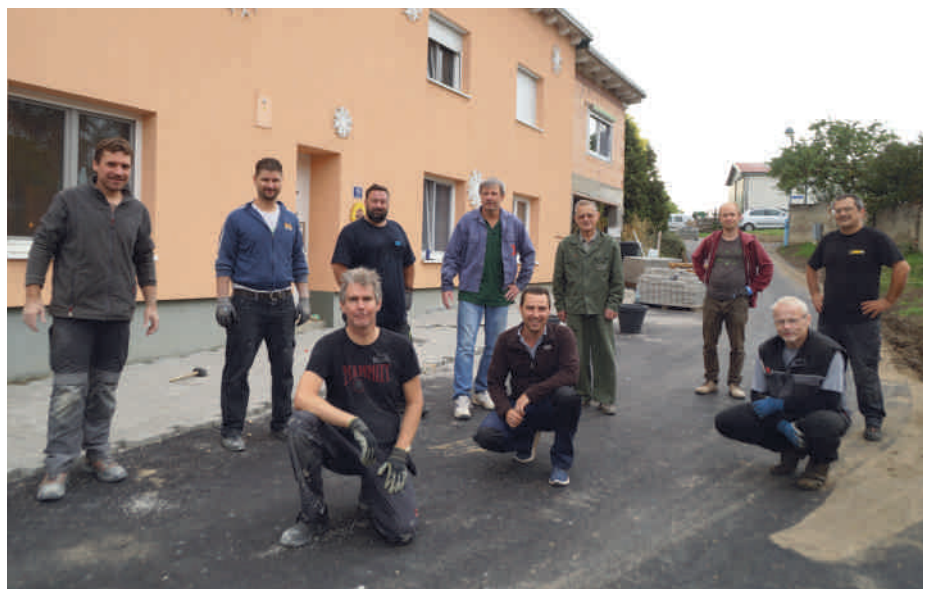
Foto: Die Helfer aus Familien sämtlicher Anrainer pflastern die neuen Parkflächen der Ernsdorfer Hintausgasse „Im Feld“.
