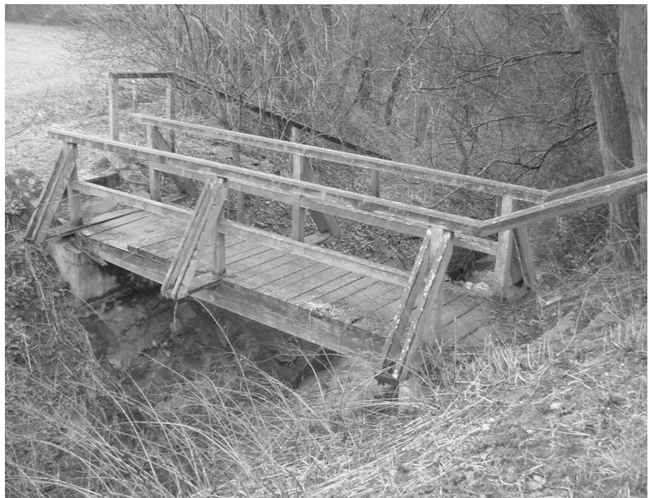
Foto oben: Die morsche Brücke über das Mühdümpfel in Enzersdorf
